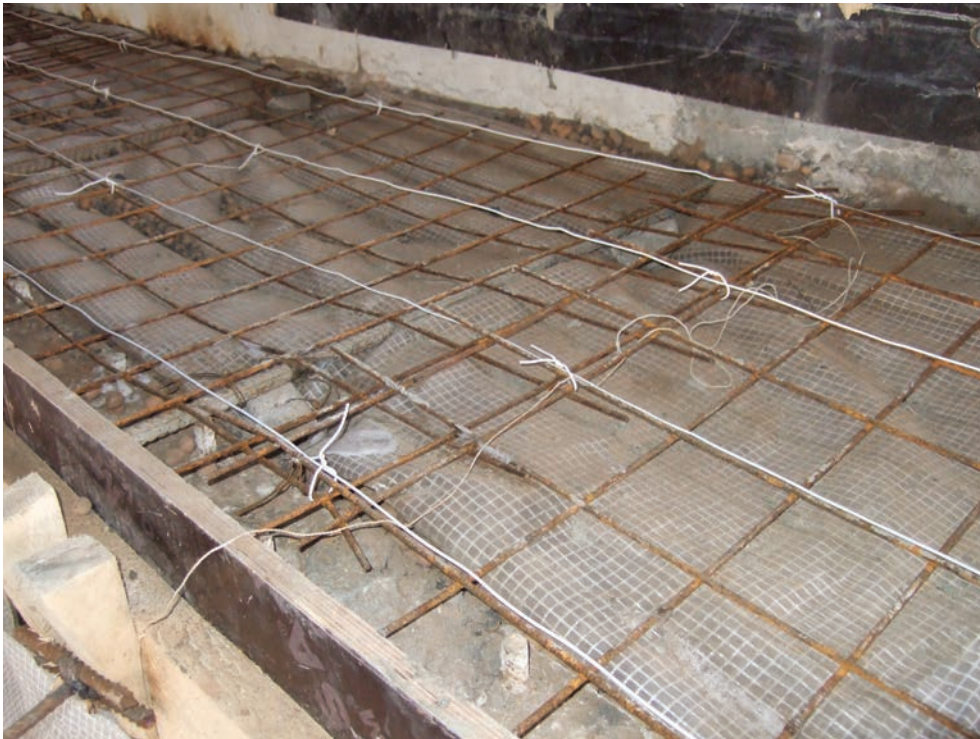
Рис. 6 Процесс установки греющих проводов при подготовке конструктивного элемента здания Академии к бетонированию
