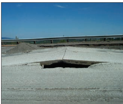
Рис. 8. Выпучивание цементобетонного покрытия в шве расширения
