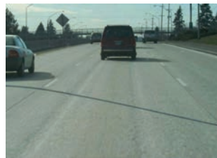
Рис. 3. Колея на цементобетонном покрытии фривея I-90 в шт. Вашингтон вблизи г. Spokane; на этом участке интенсивность — 52000 авт./сутки
