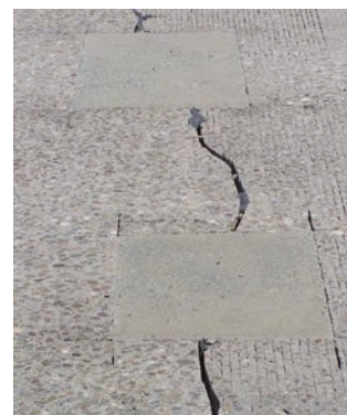
Рис. 6. Состояние цементобетонного покрытия, отремонтированного с применением композиционного материала, спустя 7 лет
