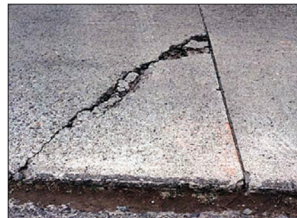
Рис. 11. Типичное разрушение угла плиты
