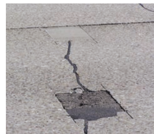
Рис. 7. Состояние цементобетонного покрытия, отремонтированного с применением композиционного материала (сверху) и традиционными методами (снизу) спустя 7 лет: ремонт традиционными методами выполняли за эти годы трижды — один раз цементобетонной смесью и два раза — асфальтобетонной
