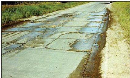
Рис. 5. Разрушенная плита покрытия со следами выплесков у кромки.
